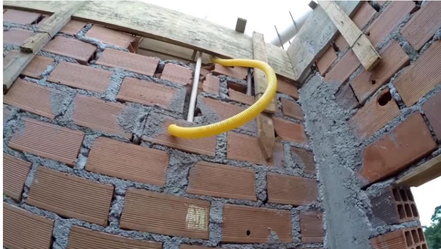
Figura 35 – Passagem dos conduítes e tubulações
