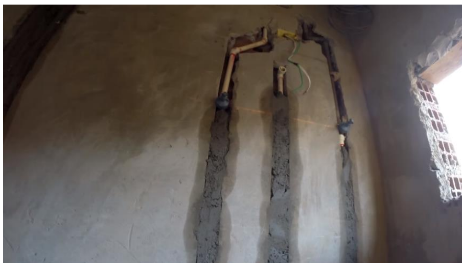
Figura 62 – Tubulações de água fria e água quente
