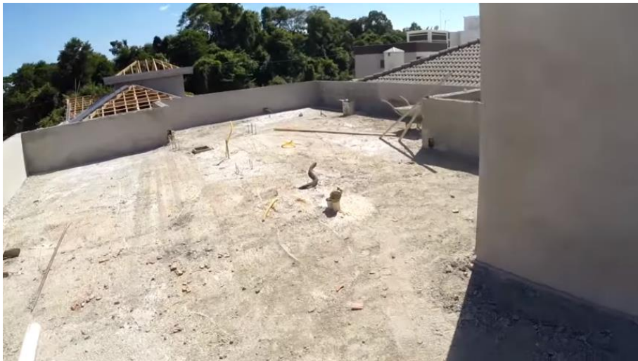
Figura 48 – Reboco da platibanda e caixa d'água
