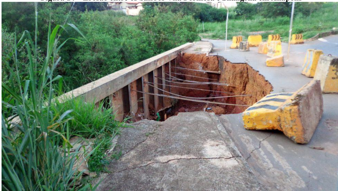
Figura 14 – Erosão entre os bairros Vila Formosa e Shangrilá em Anápolis
