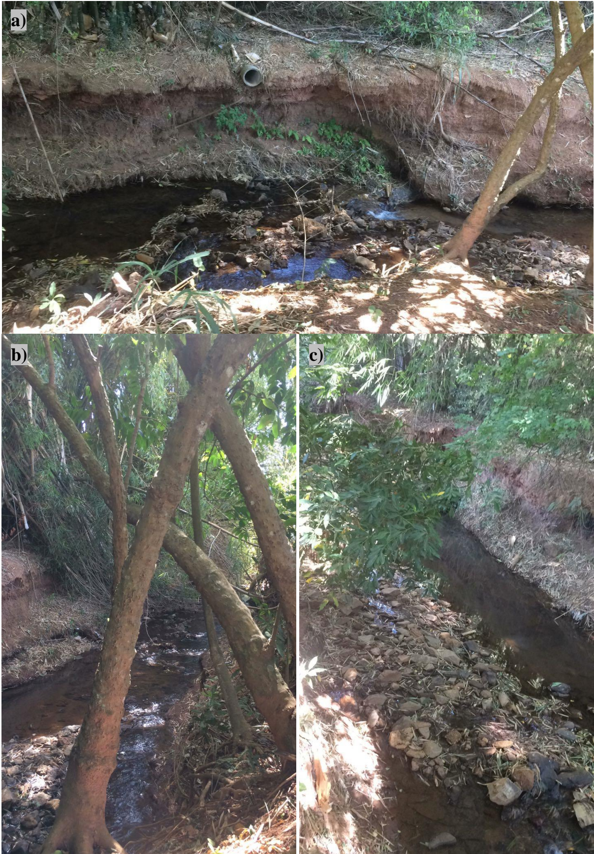
Figura 29 - Imagens do quinto ponto de observação. a) Tubulação de lançamento no trecho e falta de trabalhos de contenção. b) Vegetação predominante. c) Canal assoreado.
