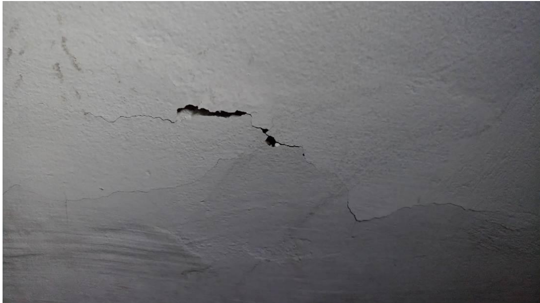
Figura 40 – Descolamento da camada de pintura em parede interna.
