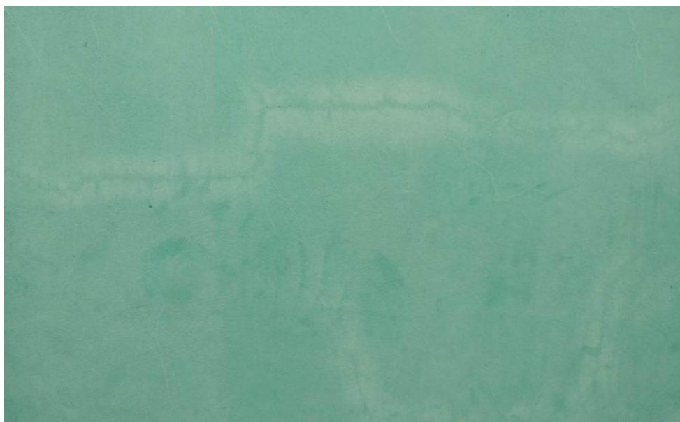
Figura 32 – Eflorescência em parede externa.
