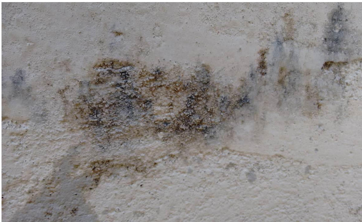
Figura 47 – Mofo em parede interna com coloração esverdeada.
