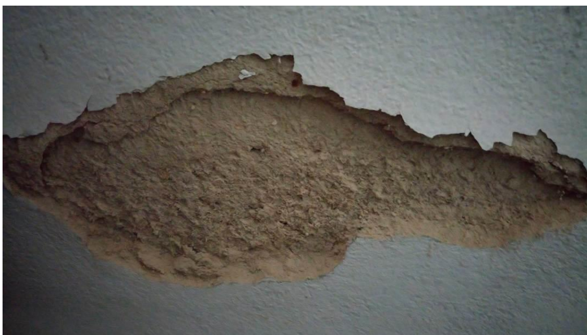
Figura 35 – Perda da aderência de materiais em parede.
