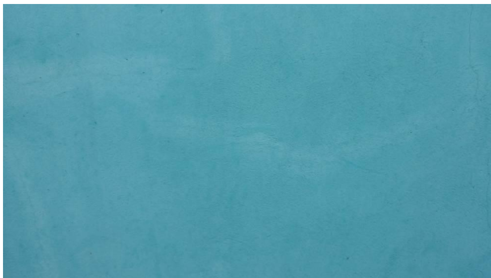
Figura 33 – Eflorescência em parede externa.
