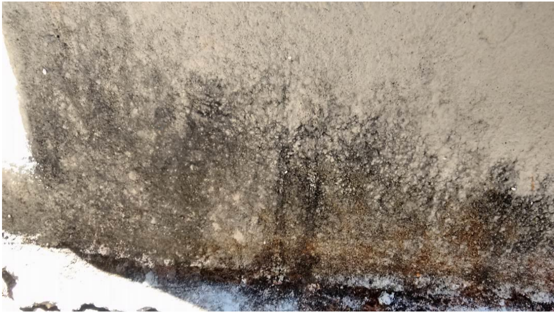
Figura 45 – Mofo em parede externa.
