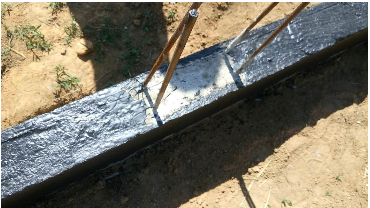
Figura 4 – Local de origem de pilares nas vigas devem ser impermeabilizados.
