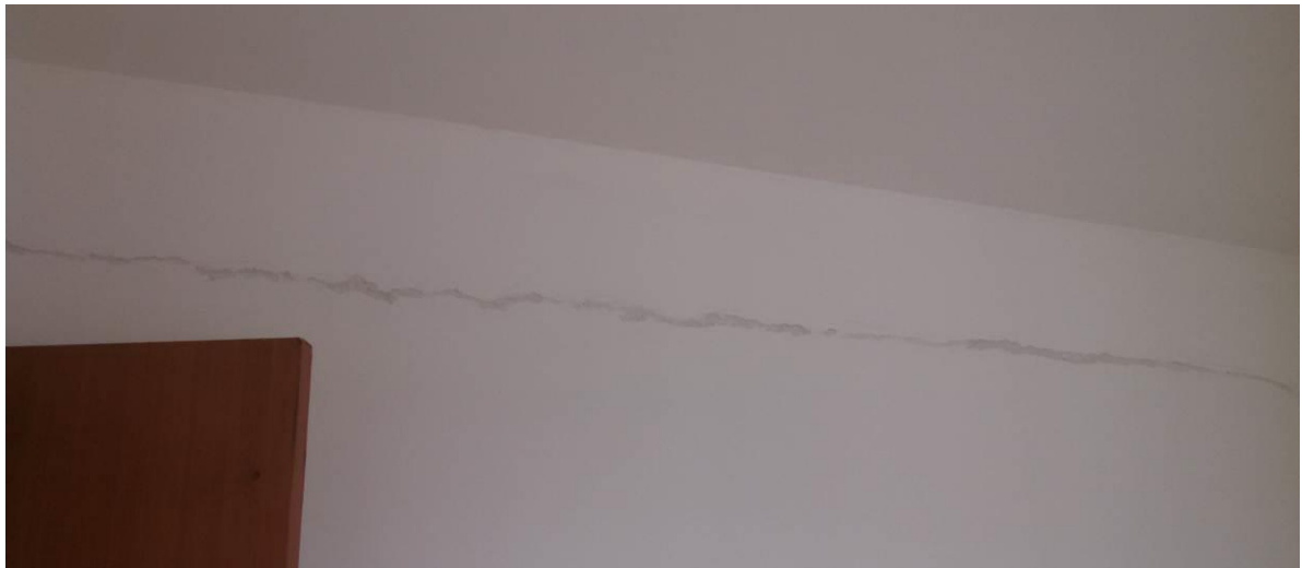
Figura 28 – Fissura horizontal devido expansão diferencial dos componentes.
