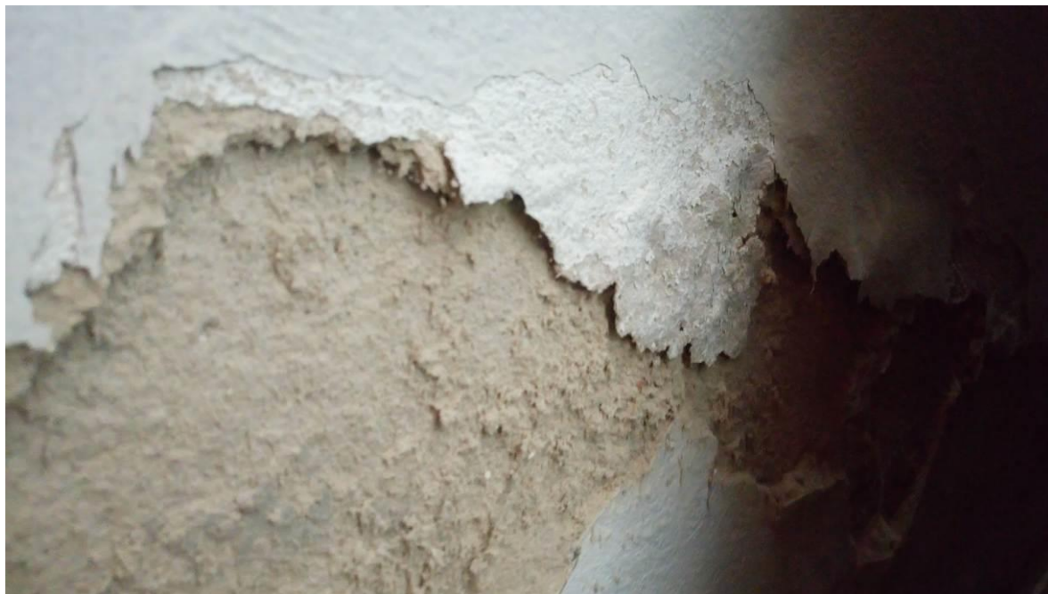
Figura 36 – Perda de aderência em paredes.
