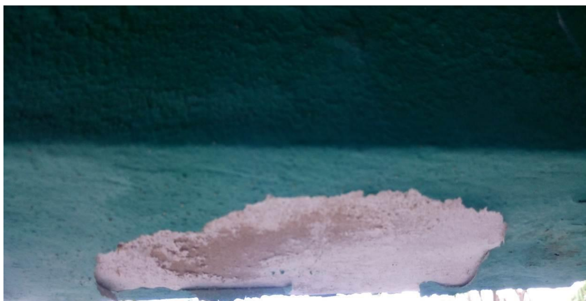
Figura 37 – Descolamento da camada de pintura em parede.
