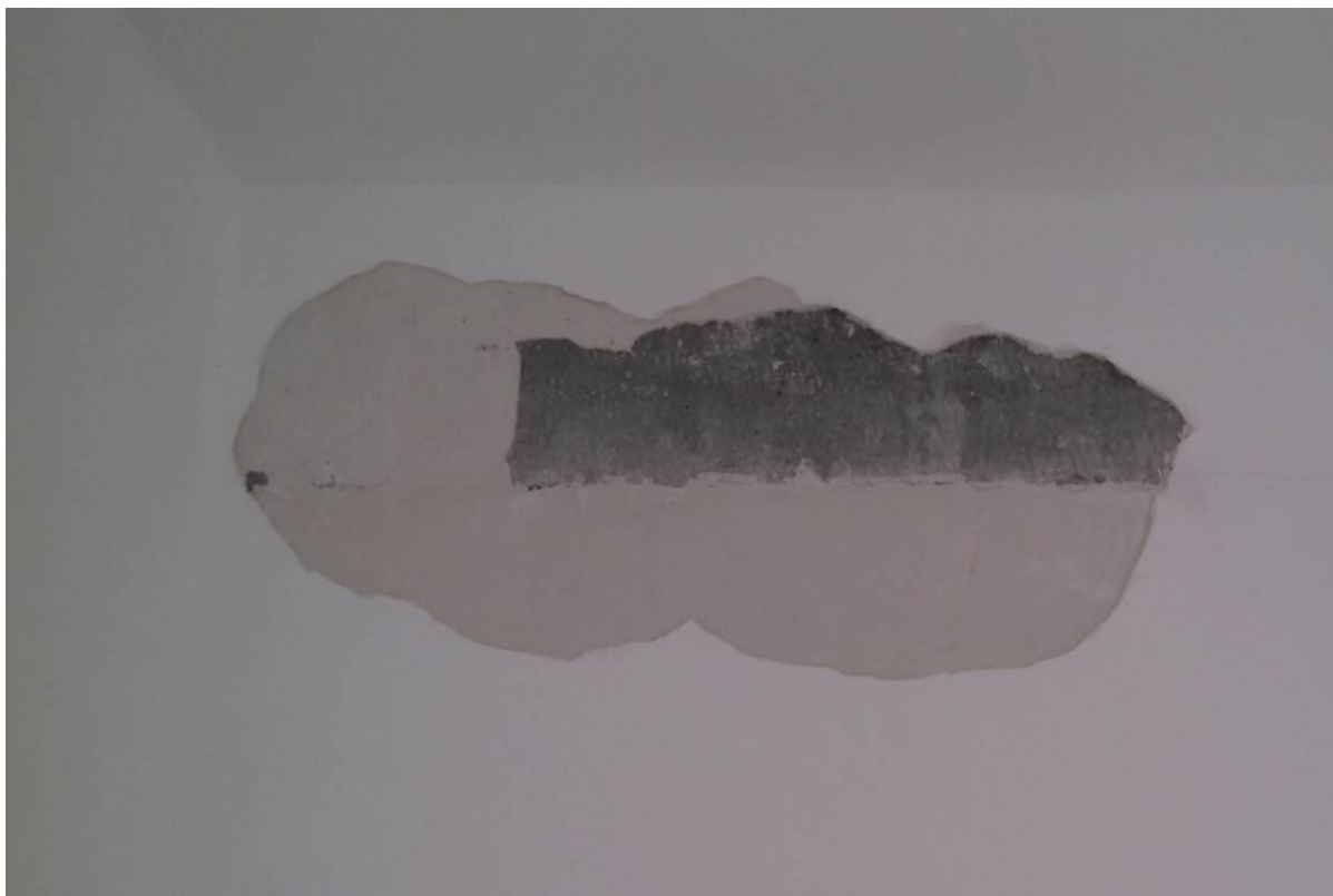
Figura 42 – Descolamento da pintura e umidade presente em viga.
