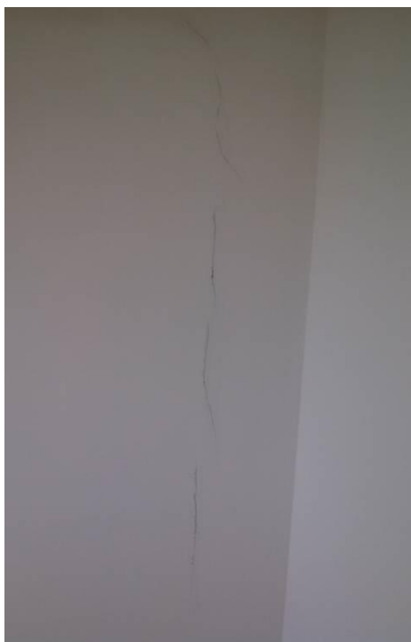
Figura 30 – Fissura vertical interna devido expansão dos componentes.
