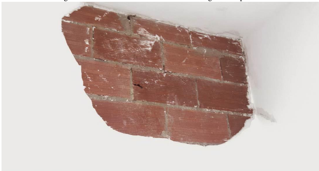
Figura 41 – Descolamento do revestimento de gesso em parede.
