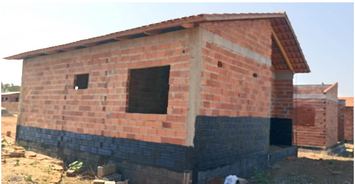
Figura 13 – Imóvel após a aplicação do impermeabilizante flexível a base de emulsão asfáltica.
