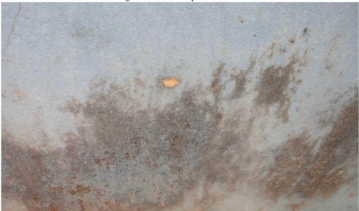
Figura 46 - Mofo em parede externa.
