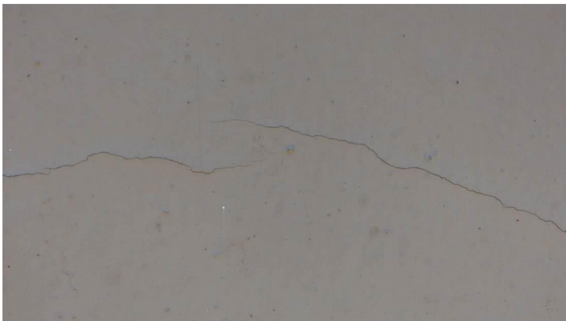
Figura 31 – Fissura na parte externa.
