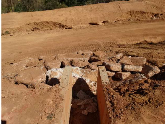
Figura 43 - Dissipador de energia. Obs. Pedras soltas na saída da descida d'água
