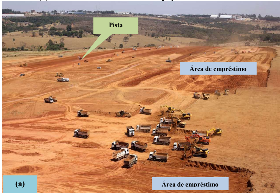
Figura 19 - Áreas de empréstimo mostradas através de fotografias tiradas através de Drones. (a) – Cortes do terreno, ao lado da pista, em franca atividade. (b) – Cortes do terreno com a obra já paralisada.
