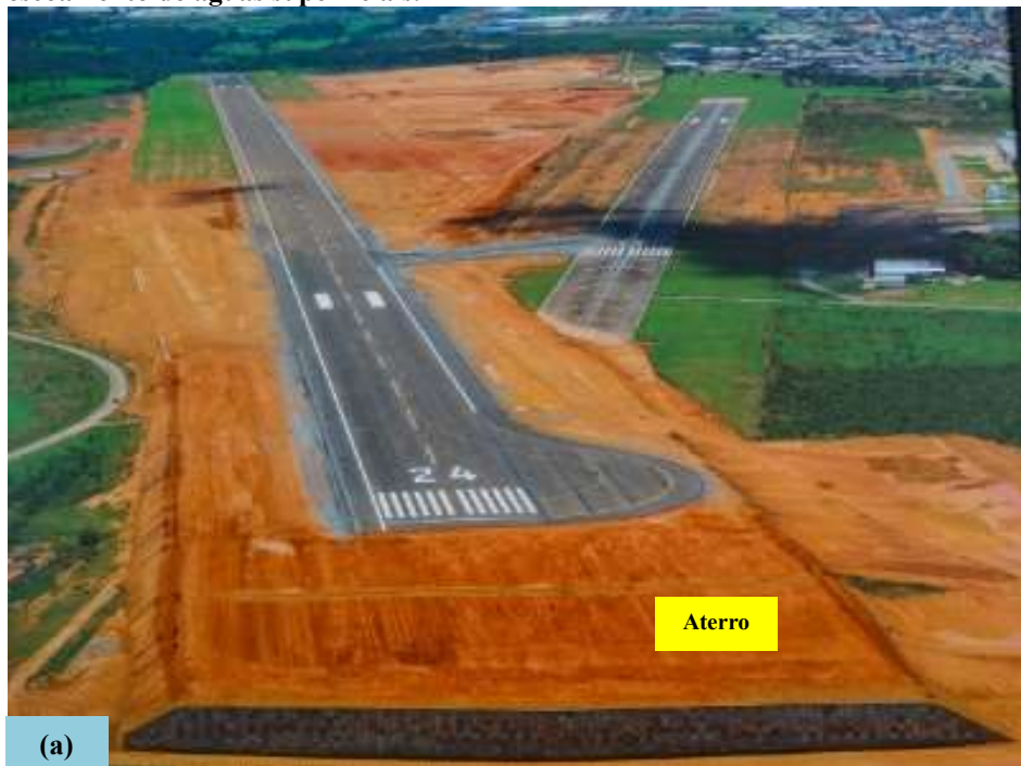
Figura 29 - Aterro da cabeceira 24. (a) Vista geral através de fotografia aérea tirada por drone, (b) Vista lateral do aterro, (c) Valeta aberta na parte superior do aterro, cerca de 10 antes do muro de arrimo terra armada, para ajudar no escoamento de águas superficiais.
