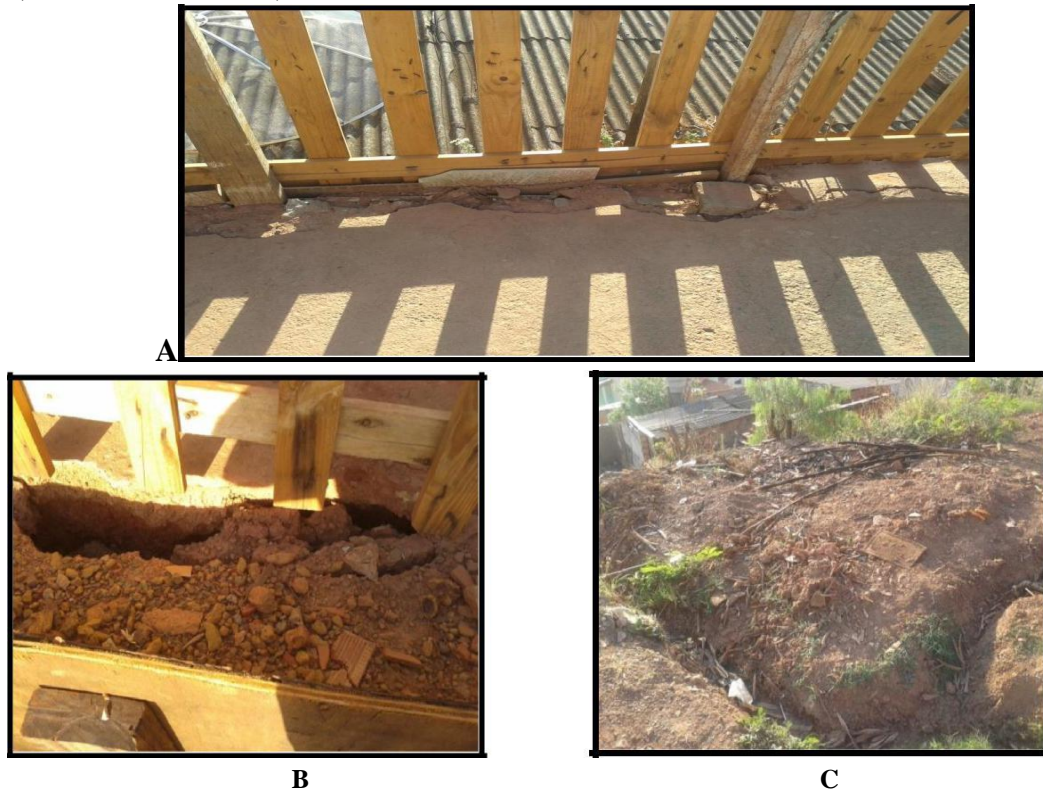
Figura 18 - Registros fotográficos que indicam problemas geomorfológicos no AP localizado no Jardim São Paulo, afetando os moradores, 2016.
