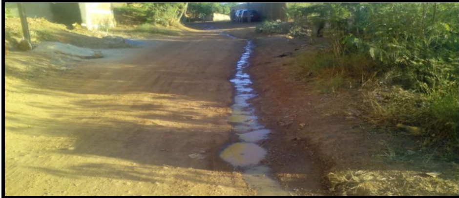
Figura 20 - Imagens de ruas do AP localizado no Jardim São Paulo onde a falta da infraestrutura do asfalto contribuem para formação de buracos e sulcos acumulando água parada, 2016.
