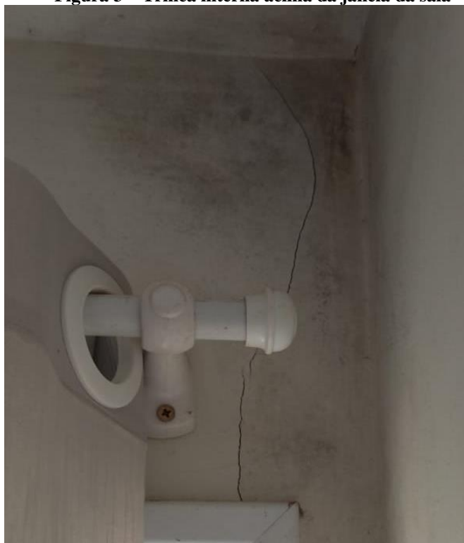
Figura 3 – Trinca interna acima da janela da sala
