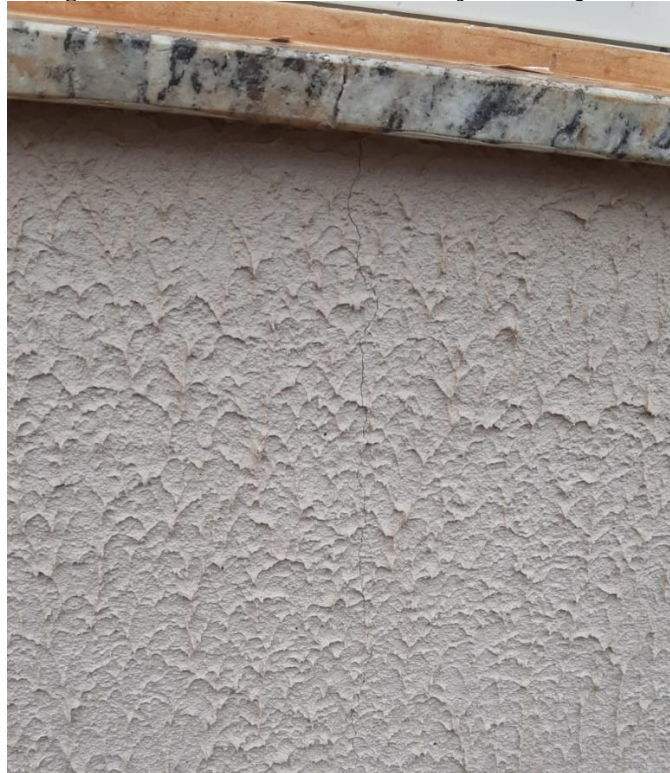
Figura 5 – Trinca externa abaixo da janela do quarto
