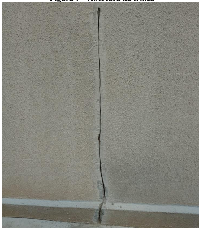
Figura 9 – Abertura da trinca
