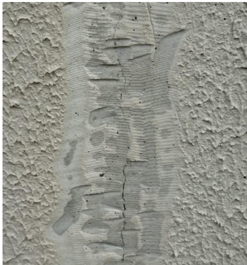
Figura 8 – Remoção da textura envolta da trinca
