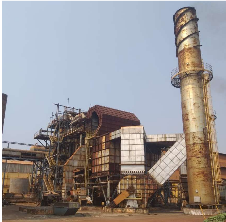
Figura 4 - Caldeira a vapor capacidade 150 T/h - Usina Goianésia
