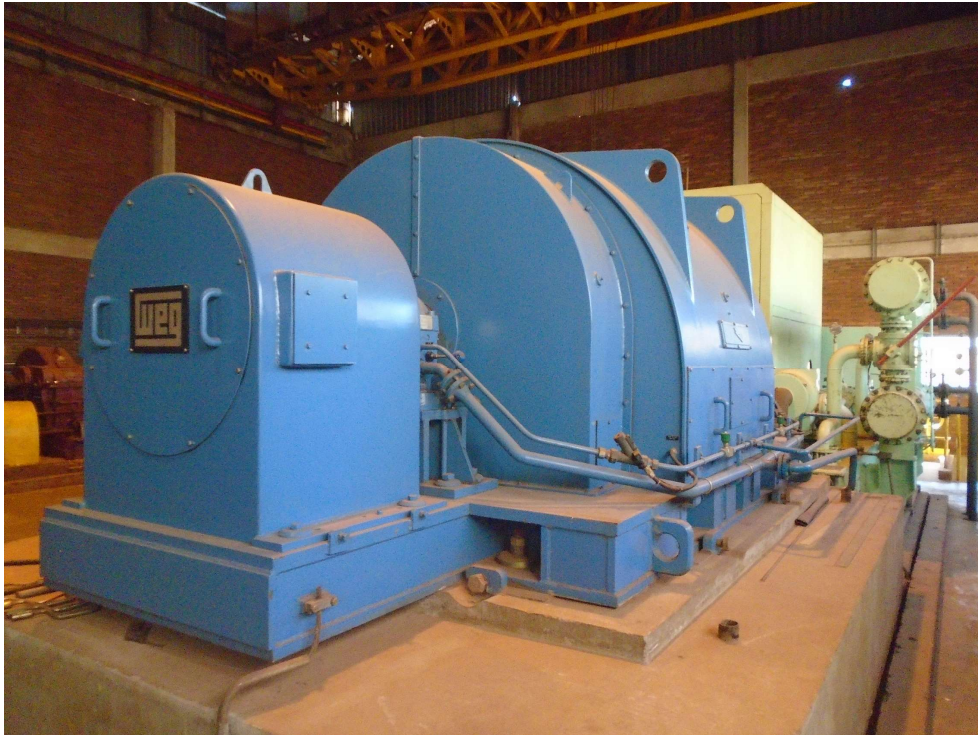
Figura 13 - Gerador WEG usina Goianésia
