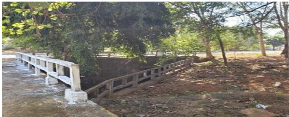
Figura 7 - Área do córrego mostrando erosão, assoreamento e alagamento em períodos de chuva.
