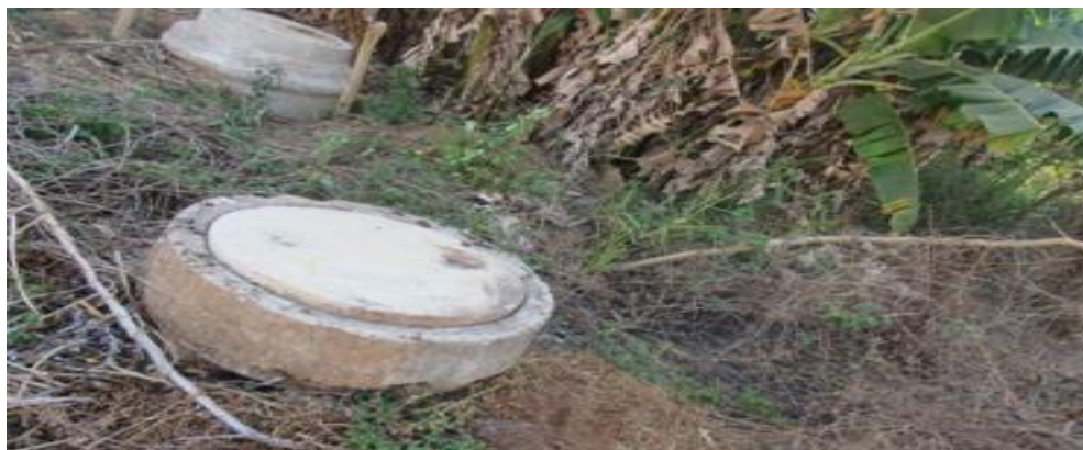
Figura 13 - Segundo poço de visita com sinais de vazamento.
