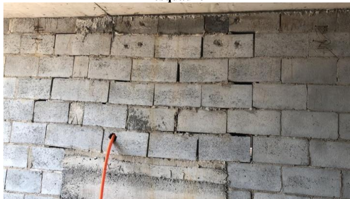
Figura 22 - Parede da escada desnivelada, fora de prumo e esquadro
