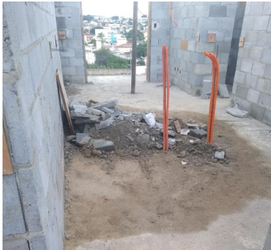
Figura 27 - Resíduos de argamassa de assentamento
