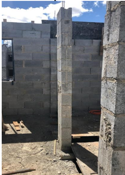
Figura 21 - Parede do elevador fora de prumo
