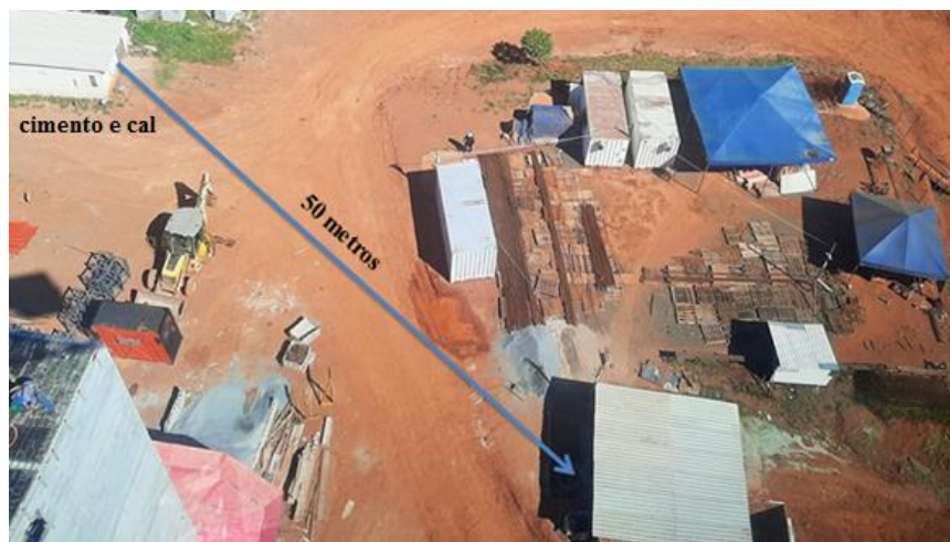
Figura 15 - Distância entre o depósito até a central de betoneira
