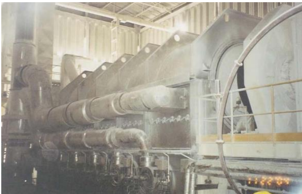
Figura 13 – Câmara de combustão de um forno rotativo.
