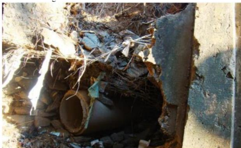
Figura 11 – Galeria de águas pluviais danificada na Vila Formosa.
