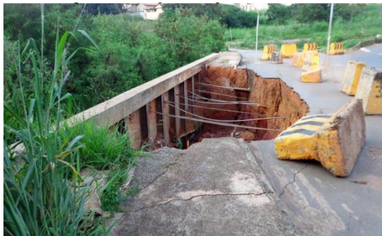
Figura 10 – Erosão: Avenida Federal
