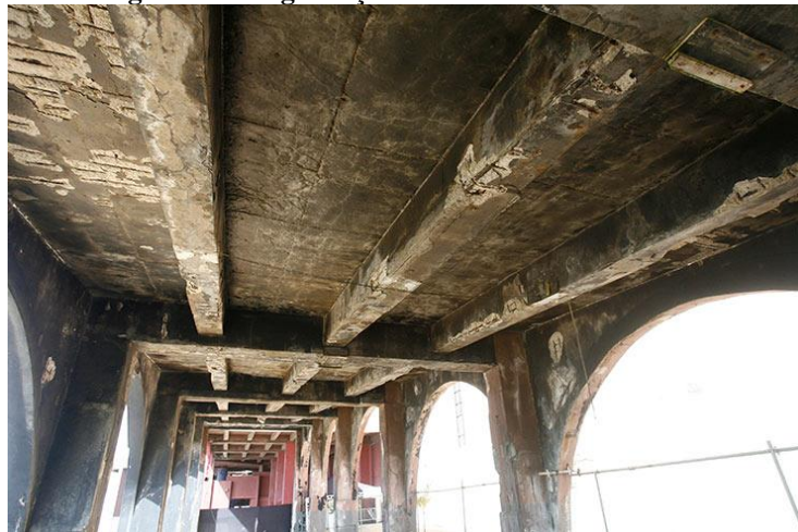
Figura 12 - Degradação em um muro de concreto
