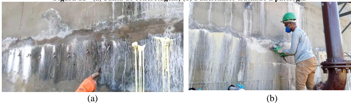
Figura 11 - (a) Junta de concretagem; (b) Funcionário tratando a patologia
