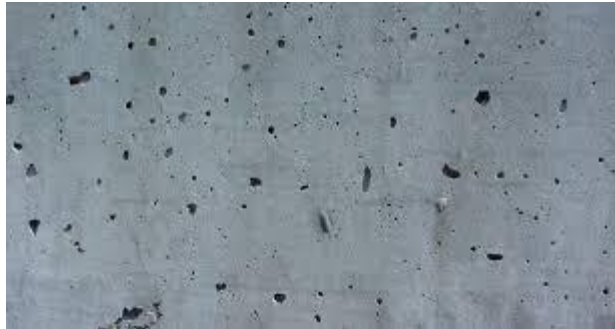
Figura 10 - Exemplo de Bolhas de ar em peças de concreto
