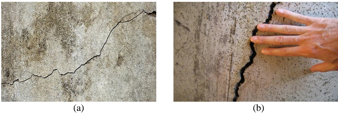
Figura 9 - (a) Fissura superficial em peça de concreto; (b) Fissura profunda em peça de concreto
