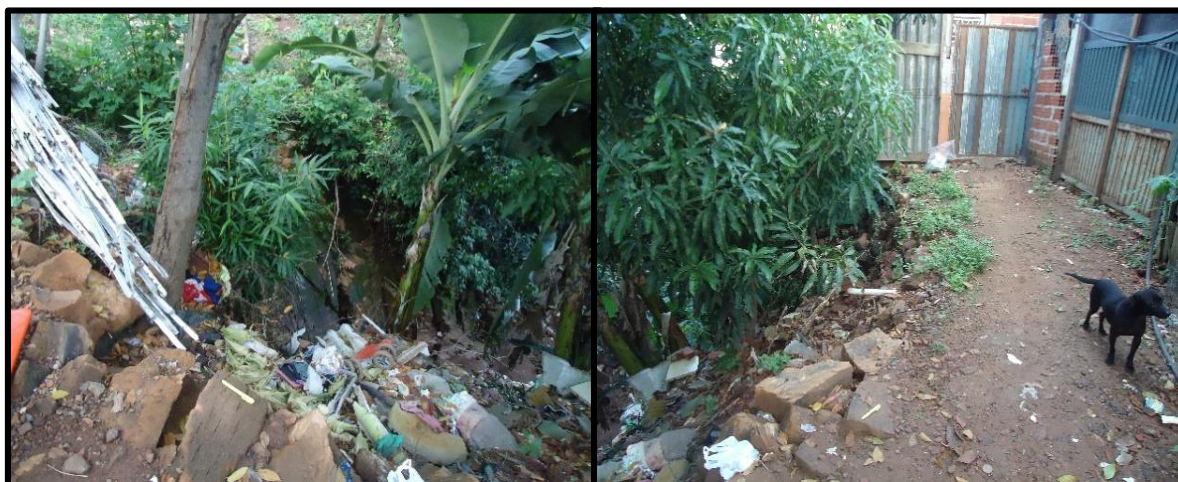
Figura 14: Erosão no bairro Novo Paraíso, Anápolis-GO.
