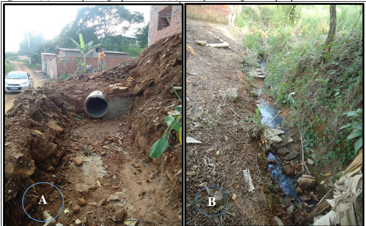
Figura 15: (A) Canalização da água por manilhas; (B) Presença de uma água turva que apresentava mal cheiro.
