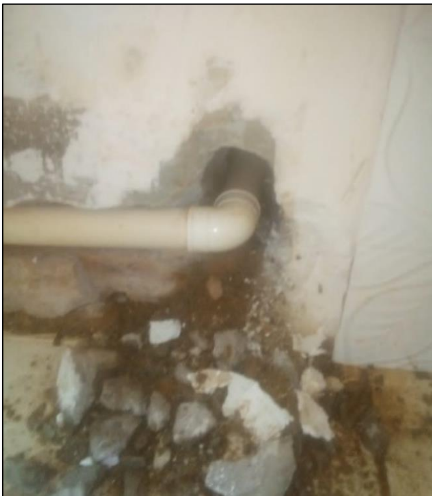
Figura 15 - Quebra da parede atingida pela infiltração
