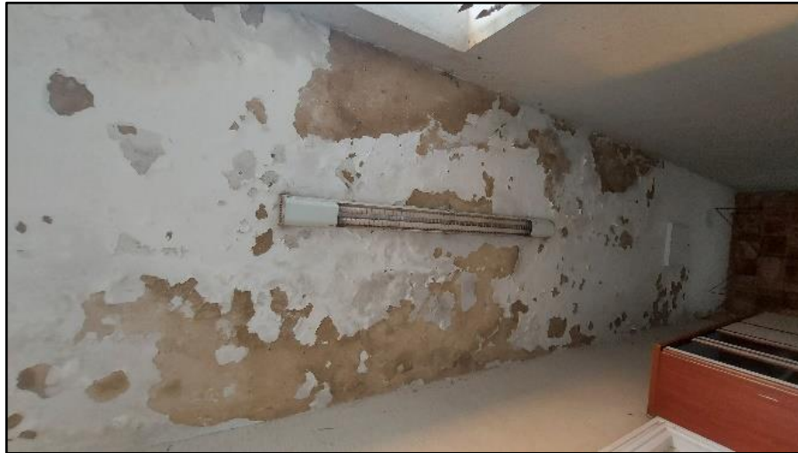
Figura 23 - Danificação de cobertura
