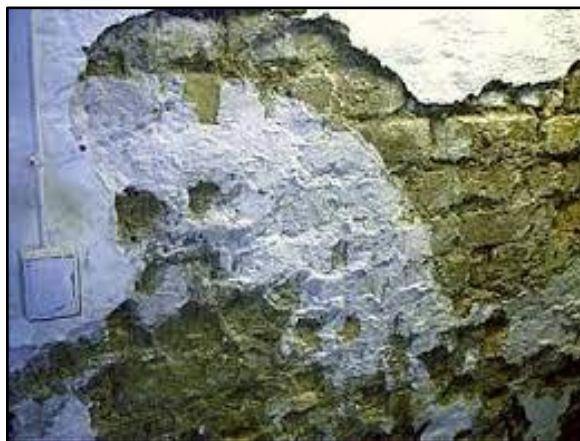
Figura 10 - Criptoflorescência em alvenaria
