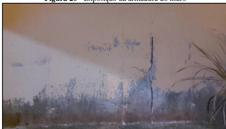
Figura 20 - Exposição da armadura do muro
