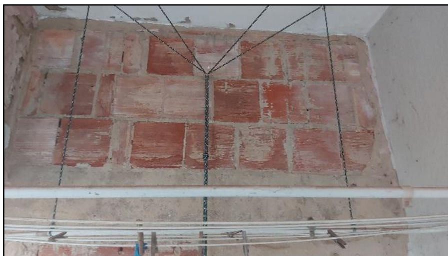
Figura 24 - Alteração visual de alvenaria
