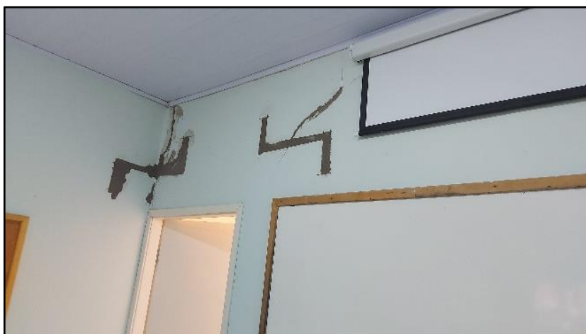
Figura 17 - Trincas na parede
