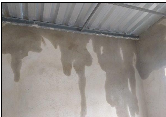
Figura 3 - Infiltração da chuva
