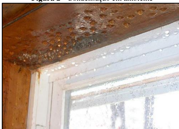
Figura 2 - Condensação em ambiente
