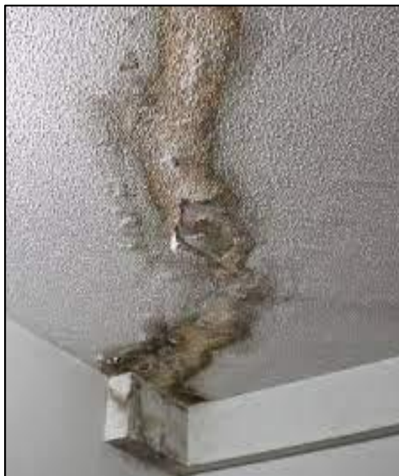
Figura 5 - Mancha devido a goteira
