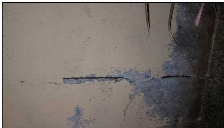
Figura 19 - Deteriorização do concreto
