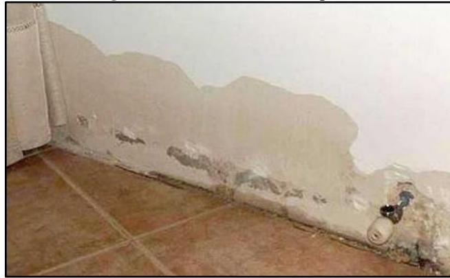
Figura 6 - Mancha na base da parede
