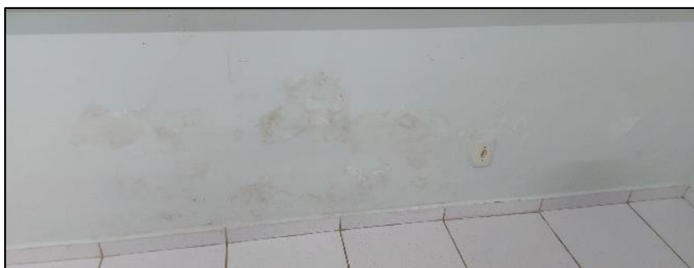
Figura 16 - Manchas na parede
