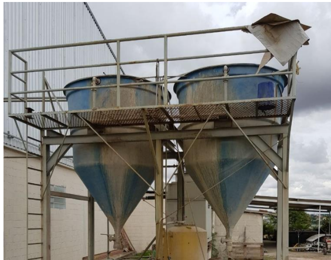
Figura 17 – Reservatório em que é utilizado o sulfato de alumínio
