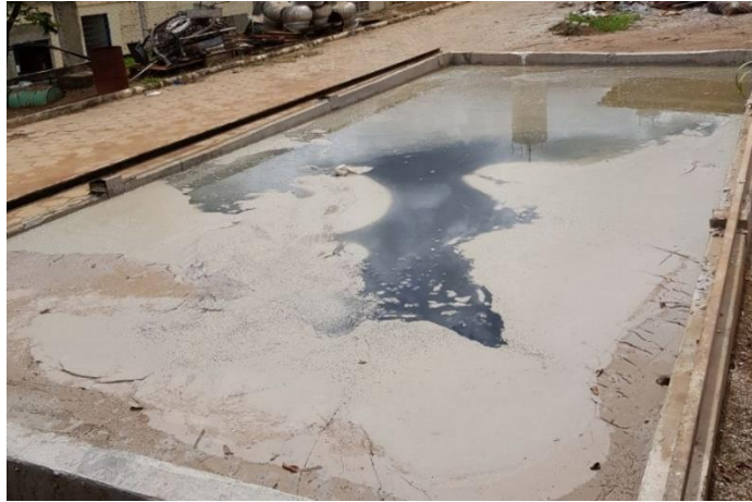
Figura 18 – Reservatório de decantação
